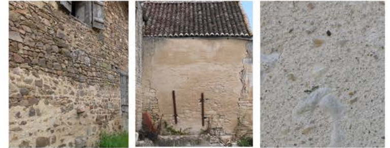
Enduits dégradés à restaurer - Enduit avec des agrégats de tailles différentes
