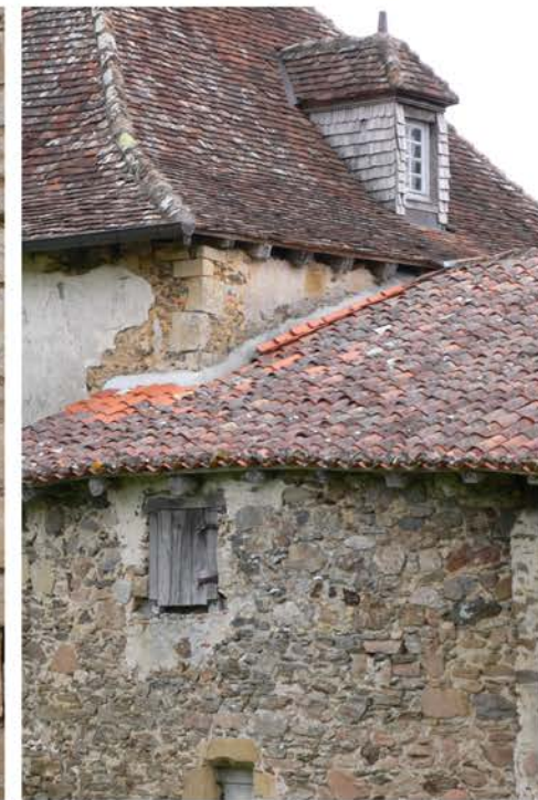
Moellons granitiques non équarris et non assisés dont l'enduit s'est délité
