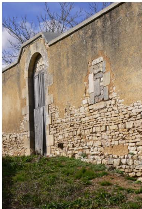
Enduit dégradé sur maçonnerie de moellons
