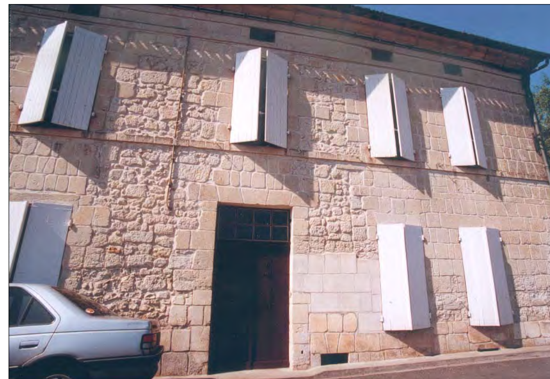
Rue Véry, parcelle 235 . Immeuble de construction fin XVIII ème - début XIX ème siècle avec un étage attique et corniche en pierre . La façade en moellons de pierres est dégarnie de son enduit traditionnel . Le bandeau est confondu avec les appuis de baies.
