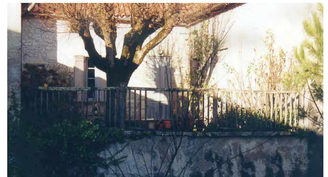
Parcelle 413, rue Véry. Une rambarde de bois qui semble fragile.
