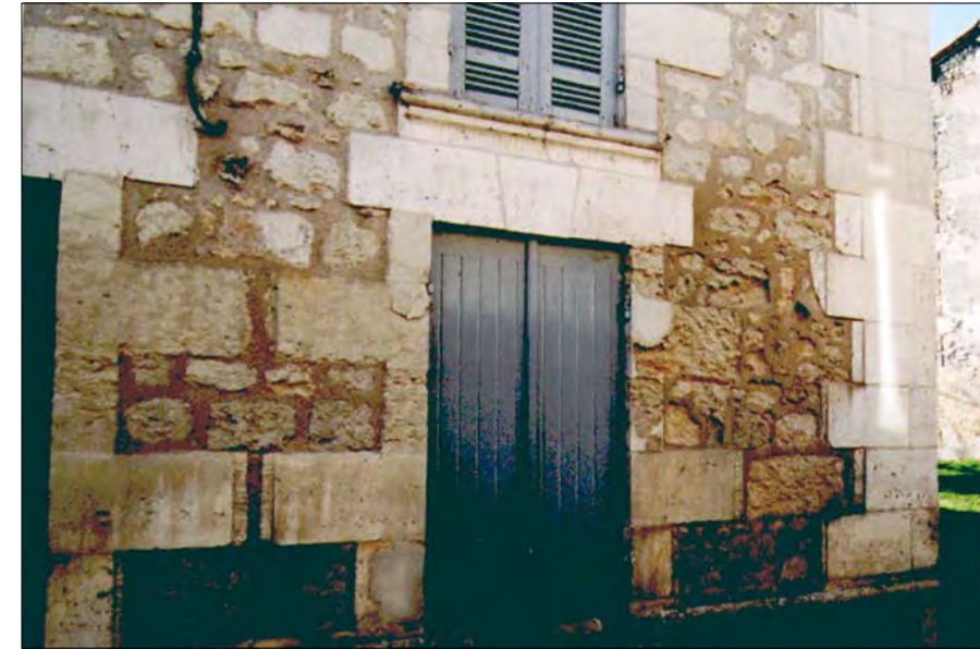
Parcelle 198, rue Véry. Maison d'habitation en moellons et pierres de taille : cette façade devrait être enduite laissant apparent les encadrements de baies, et chaînages harpés en pierres de taille.
