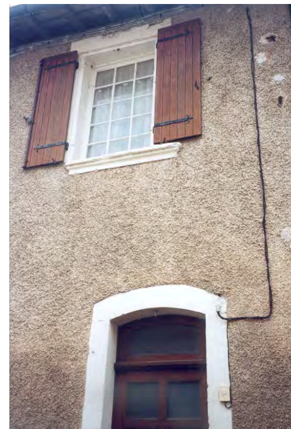
Parcelle 93, rue Saint Jean. Baies, volets modifié et crépis au ciment.
