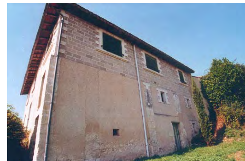
...mais côté jardin, elle est totalement défigurée par une extension en agglomérés de ciment laissés apparents, et des baies mal dessinées;
